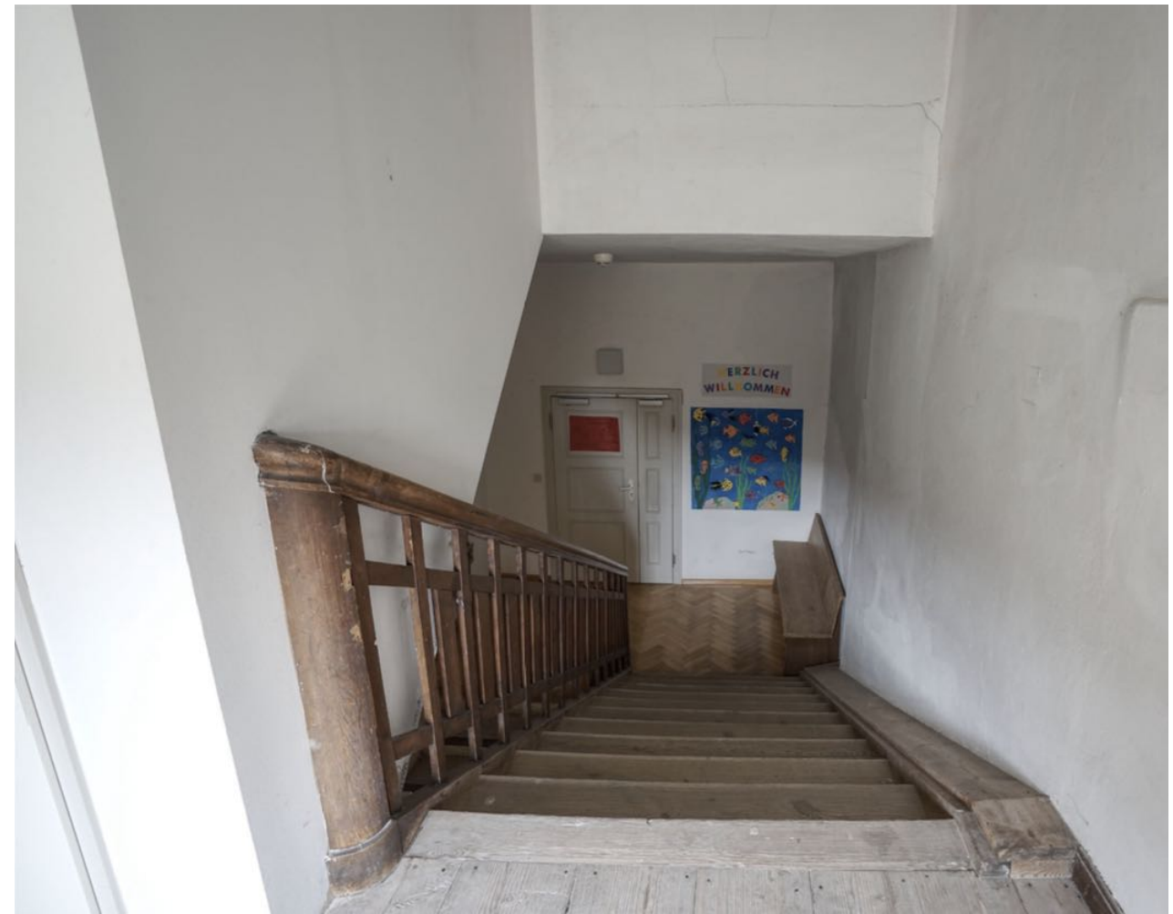
Treppe 2 - Blick vom Podest DG: Der oberste Lauf ist ohne PVC-Abdeckung.
